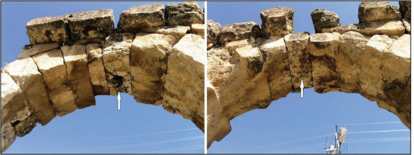
Şekil 6: Tyana kemerlerinin kilit taşlarında meydana gelen çatlak oluşumuna bağlı bozunmalar
